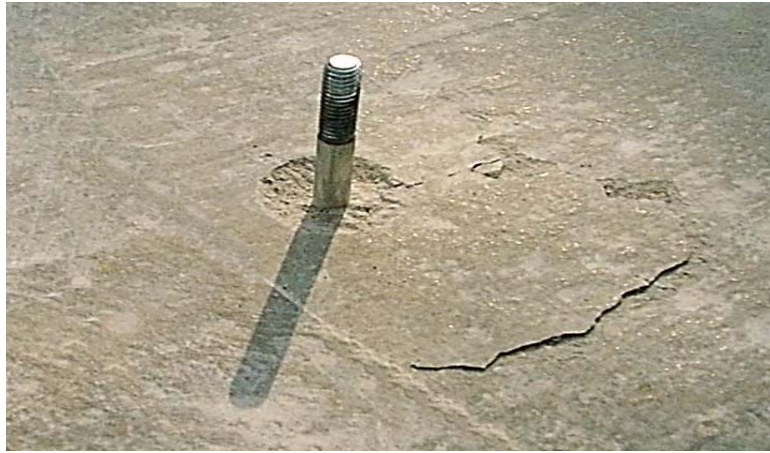
Şekil 3. Sondasının betona saplanmasıyla yüzeyde oluşan çatlak
